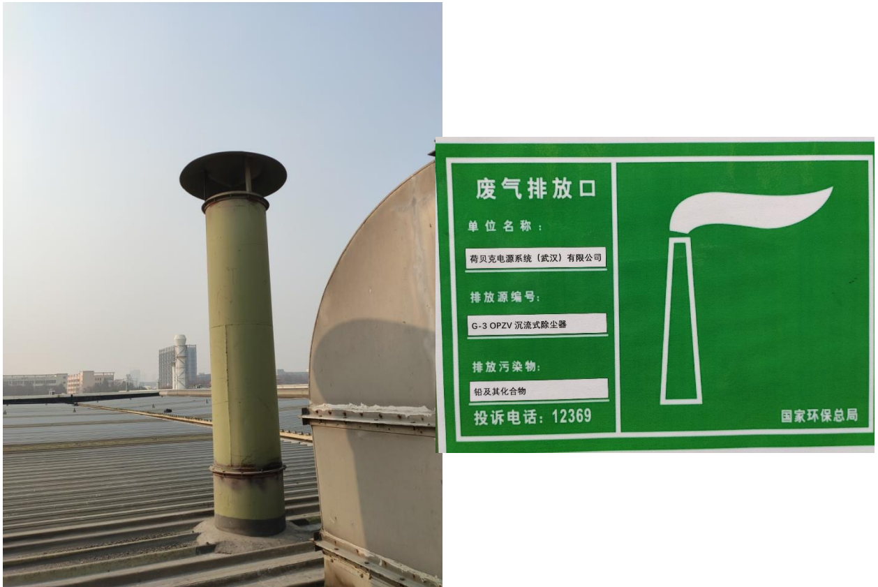
图 4-9 排气筒 (G-3) 及排放口标识
