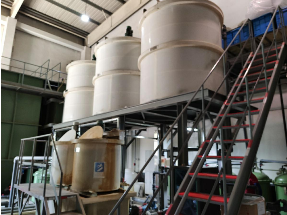
图 4-20 铅酸废水处理站
