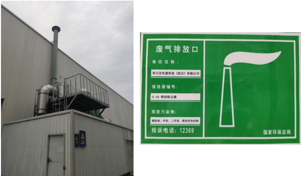
图 4-17 排气筒（G-10）及排放口标识
