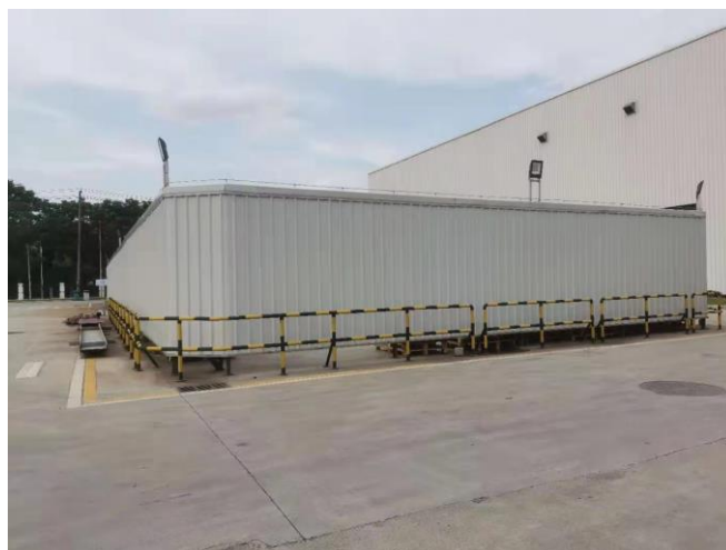
图 4-23 初期雨水池（事故状态下可作应急池使用）
