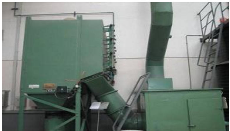
合理有效的含铅废气处理装置， 保证废气污染物达标排放
