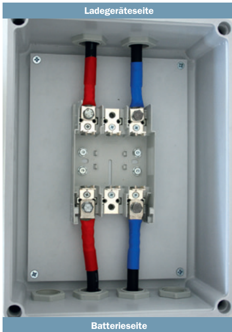
Abbildung 7: Anschluss Batteriekabel an sun.fusebox NH00
